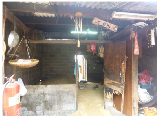
สภาพบ้านก่อนซ่อมแซม
